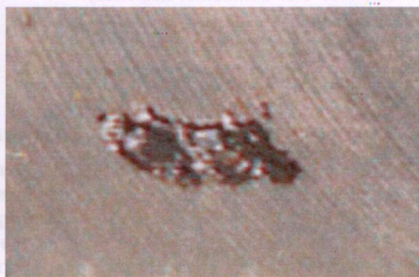
Рис. 8.4.16б. Фрагмент с дефектом (увеличено)
