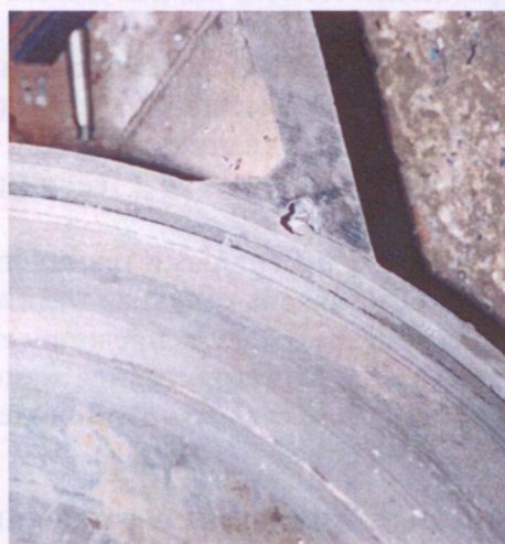
Рис. 3.2.4б. Фрагмент дефекта (увеличено)
