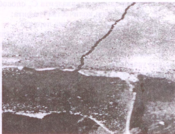
Рис. 2.3.2. Фрагмент корпусной отливки с трещиной
