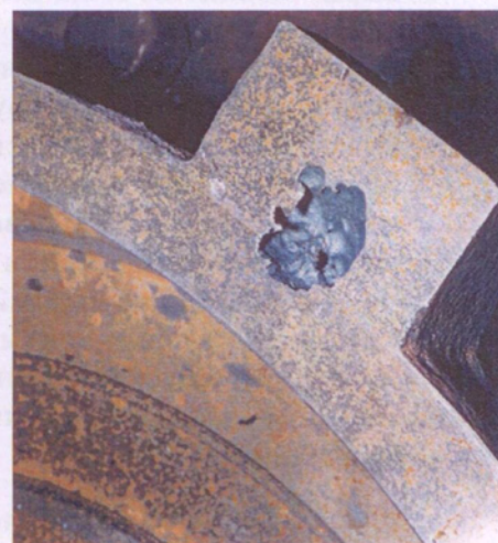
Рис. 3.2.4в. Фрагмент дефекта (увеличено)
